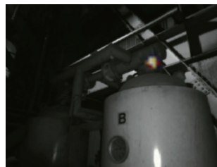
화학 가스 저장탱크 유지보수 (가스 누설)
