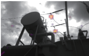
고압전류 송전선 유지보수 (다발성 부분방전)
